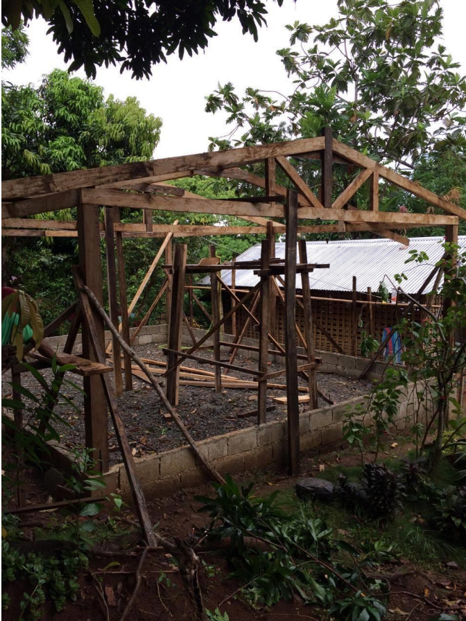
Ein Foto von der Baustelle: Die Grundmauern und das Gerüst stehen schon.
